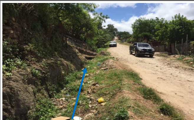
Ilustración 2. Tramo donde se construirá cuneta de 40 cm x 50 cm, al fondo se observa calzada con huella.
