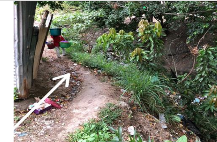
Imagen 3. Estado del paso peatonal que será mejorado ubicado sobre talud erosionado
