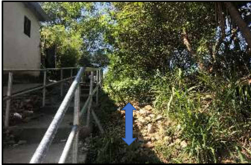
Ilustración 8 Tramo cuneta propuesta para protección contra la socavación de la estructura existente de gradas.
