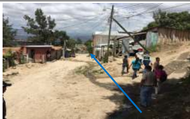
Ilustración 3. Tramo de intercepción de calles donde se construirá cunetas de 40cmx50cm con quebrapatas.
