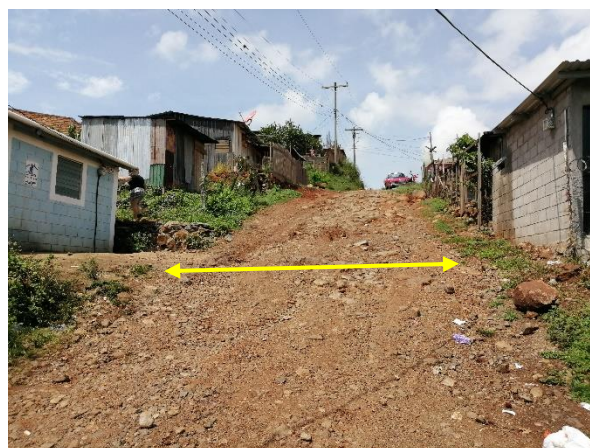
Ilustración 2. Se visualiza la falta de cunetas en las calles de la colonia
