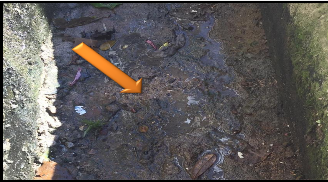
Ilustración 1. Situación actual de cunetas en la calle cinco obsérvese el desgaste debido a la abrasión en el fondo de esta, y donde se hará el revestimiento de la misma.
