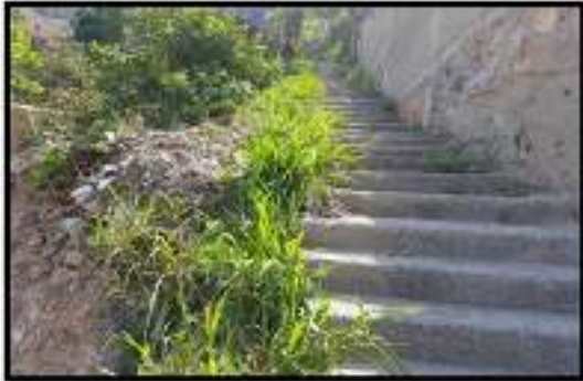
Ilustración 1. Condiciones existentes de drenaje.
