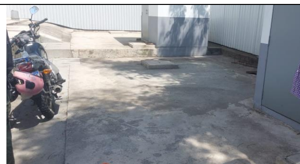
Ilustración 4: Cisterna de almacenamiento existente.
