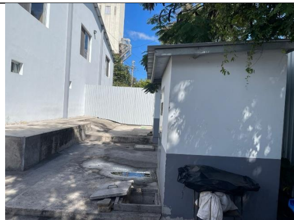
Ilustración 3: Cisterna de almacenamiento existente.
