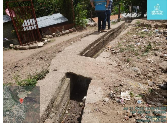
Imagen 6. Cunetas a ser demolidas y reconstruidas
