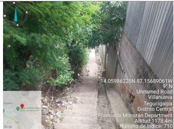
Imagen 2. Gradas a reconstruir para mejorar rutas de evacuación del sector
