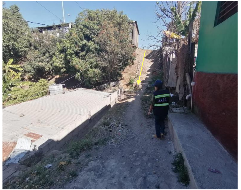
Ilustración 2. Se visualiza la falta de gradas con pasamanos que sirvan de ruta de evacuación.
