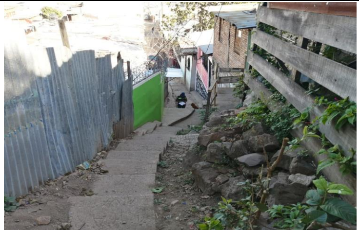
Ilustración 4. Se visualiza la falta de pasamanos en las gradas existentes.
