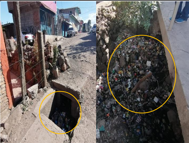
Ilustración 3. Presencia de residuos solidos sobre la quebrada y las cunetas existentes.
