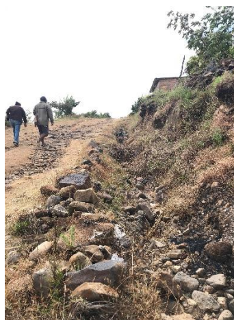
Ilustración 2. Se visualiza la falta de cunetas en las calles de la colonia
