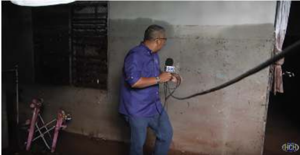
Ilustración 20. Se observa el nivel de la crecida marcado en las paredes de la vivienda identificada como 0 en la ilustración 18
