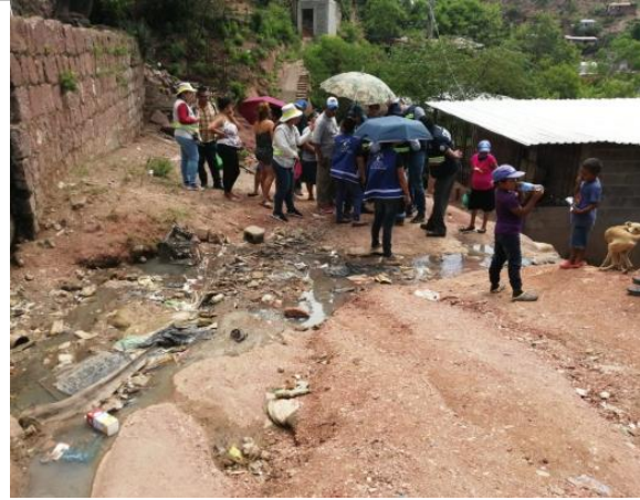
Ilustración 2. Se visualiza la falta de cunetas en las calles de la colonia
