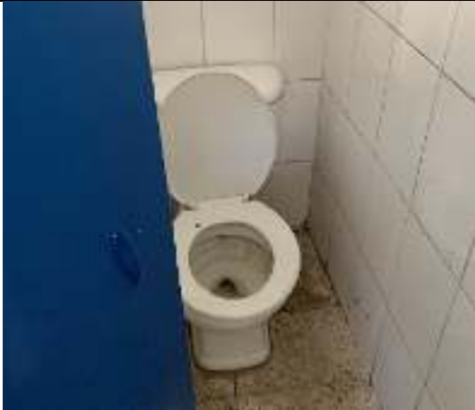
Ilustración 4: Aparatos sanitarios existentes.
