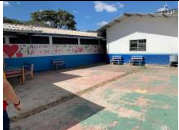
Ilustración 7: Deformación en losa existente.
