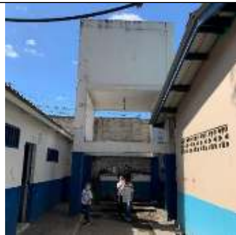
Ilustración 3: Tanque de almacenamiento existente.
