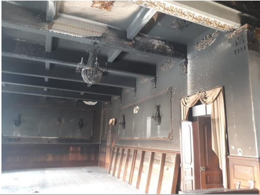
No. 3 VISTA DEL SALÓN DE CABILDOS CON EL ESTADO EN QUE SE ENCUENTRAN LOS ZÓCALOS DE MADERA.
