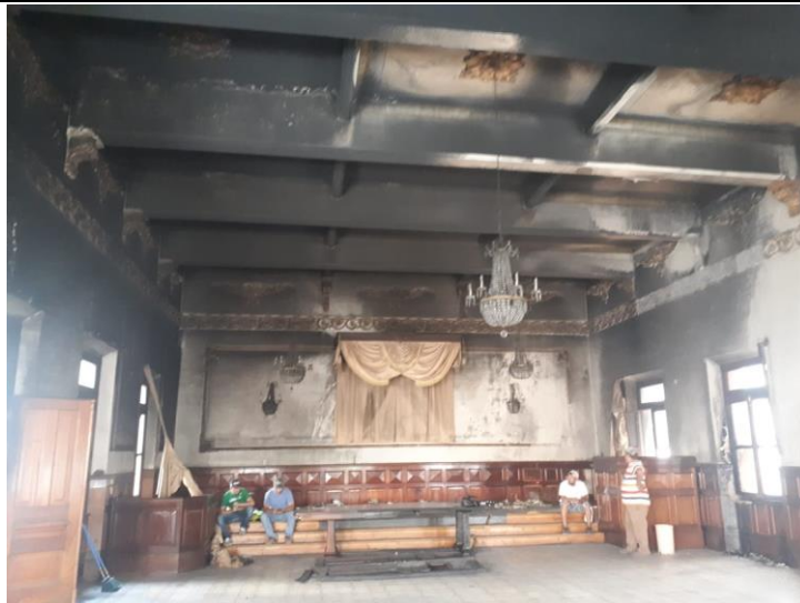
No. 2 VISTA DEL SEGUNDO NIVEL EN EL SALÓN DE CABILDOS DONDE SE REALIZARÁN ACTIVIDADES DE LIMPIEZA DE CIELOS Y PAREDES.
