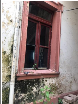
No. 6 | VISTA DE PAREDES DAÑADAS POR LA HUMEDAD EN EL PRIMER NIVEL.
