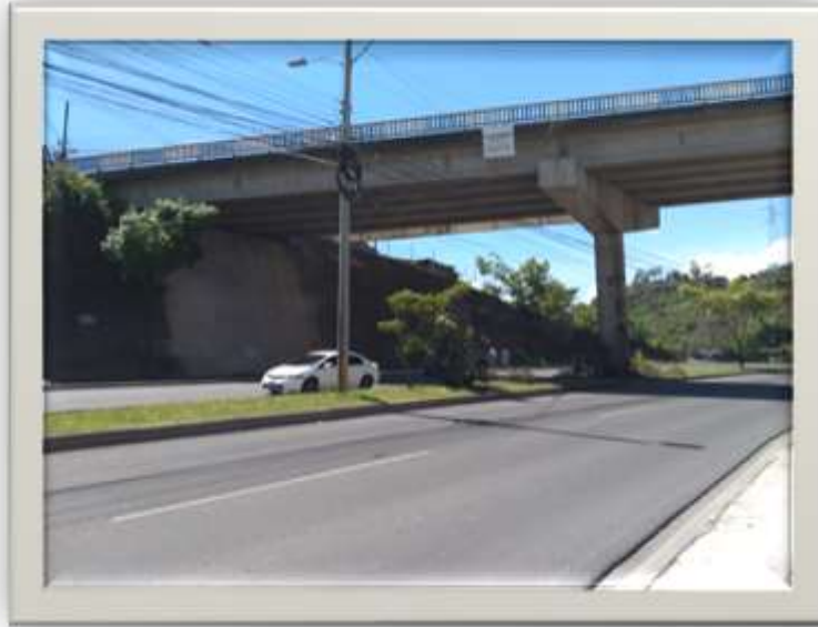
En la imagen se muestra la estructura del puente actual en el Anillo Periférico a la altura de Las Casitas
