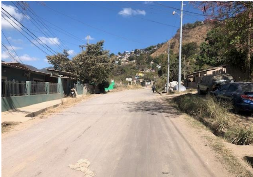
Estación 1+000, se observa falta de pavimento; ancho promedio 10.00 m.
