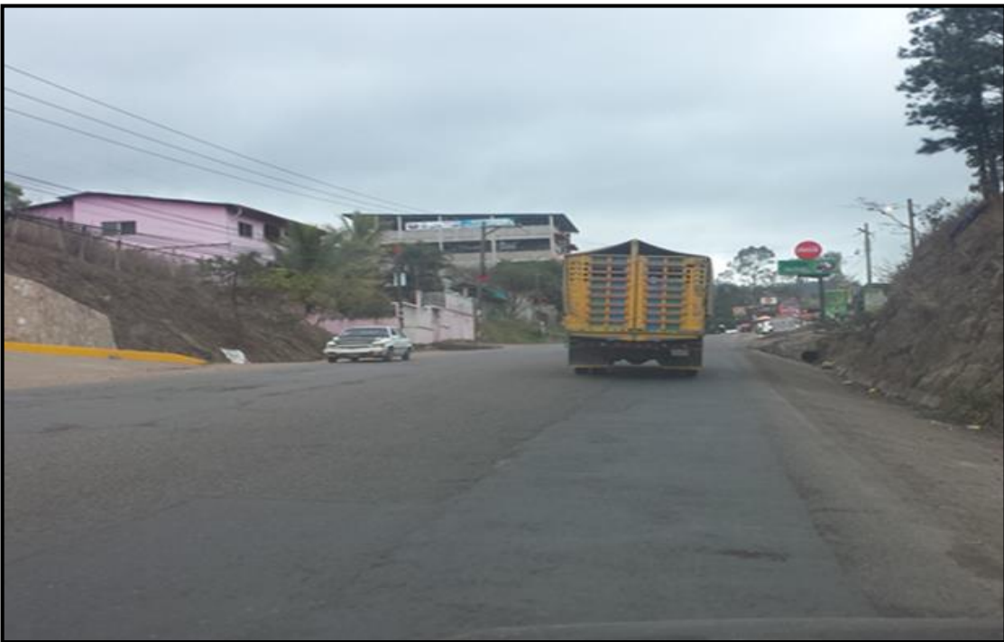
En la imagen se muestra las condiciones de la carpeta asfáltica en diferentes sitios del Distrito Central
