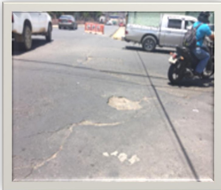
En la imagen se muestra como referencia zonas donde se realizarían trabajos de bacheo para mejorar la circulación vehicular
