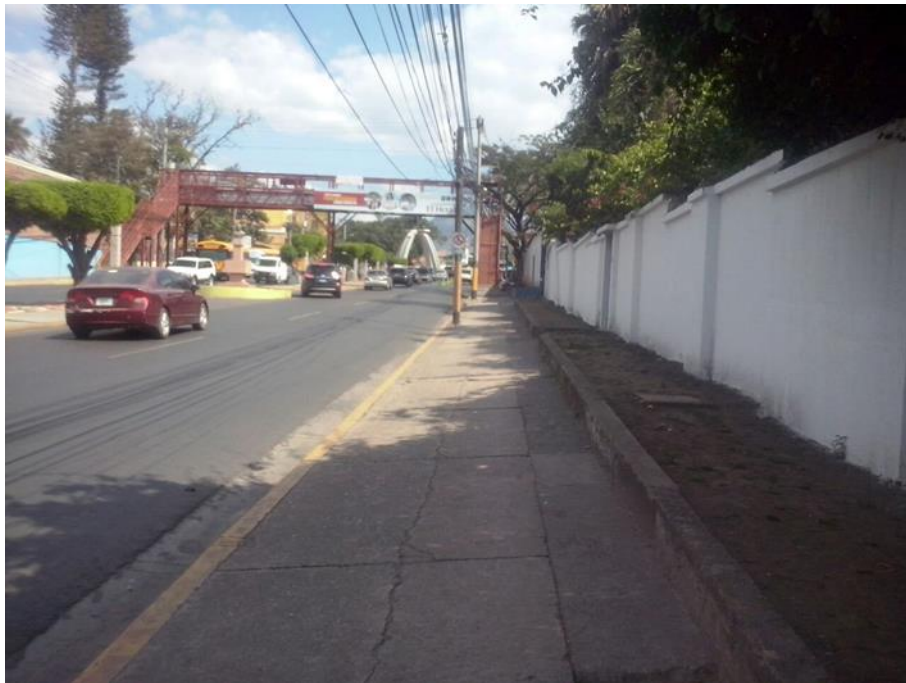
ACERA A DEMOLER EN EL BULEVAR LOS PRÓCERES
