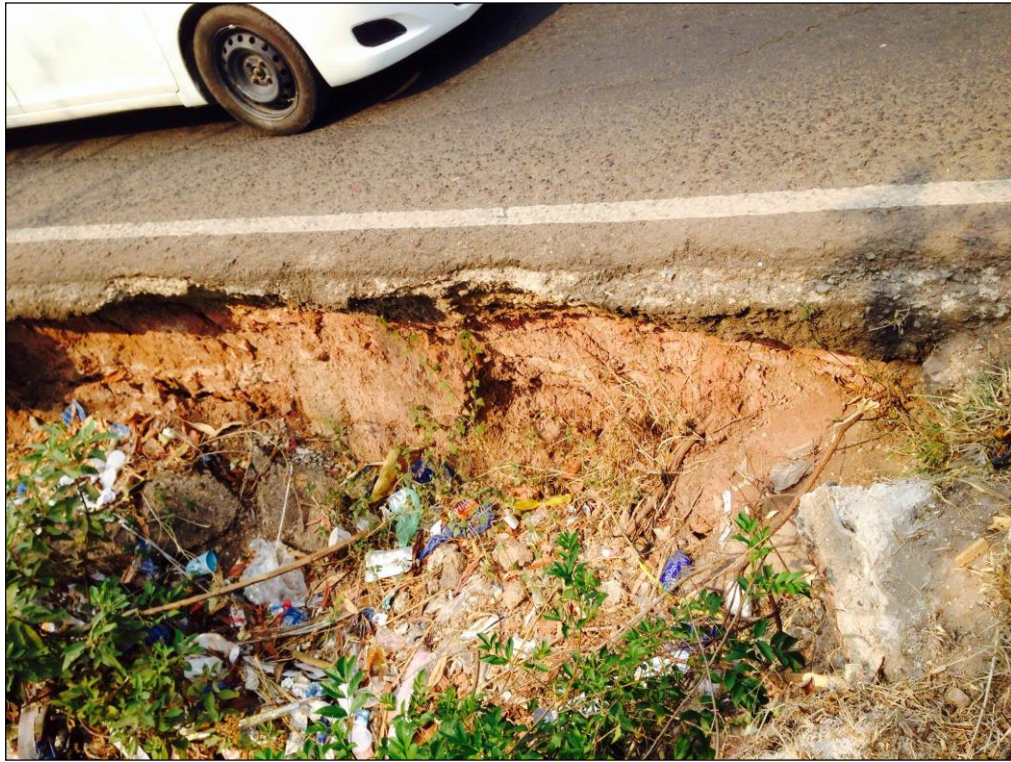
OTRA VISTA DE LOS DAÑOS A CAUSA DE LA FALLA
