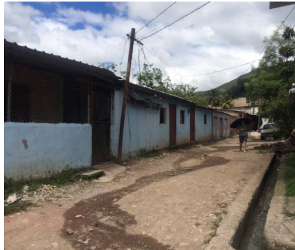
Se observa el ancho y el estado actual de la calle tramo #1.
