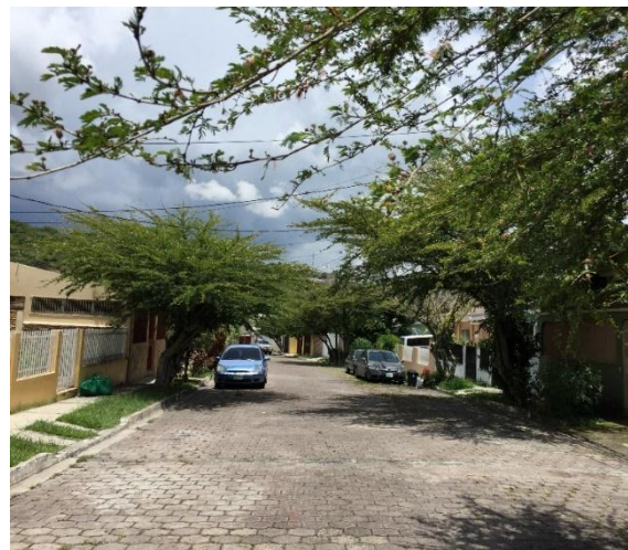
Estado actual del adoquín que se desmontará.
