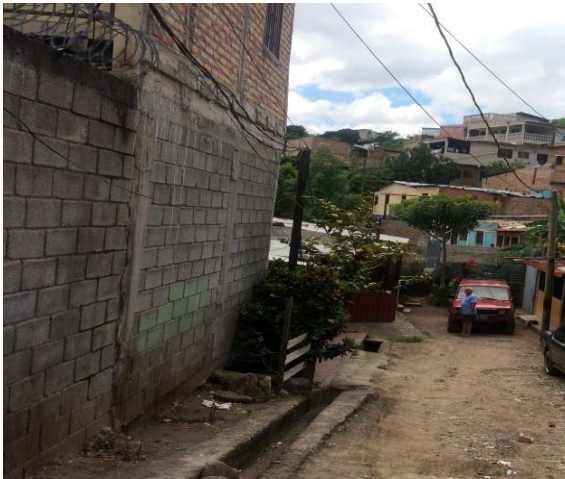
Se observa el ancho y el estado actual de la calle del tramo #1.
