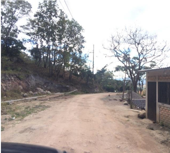
Calle de terraceria en mal estado.
