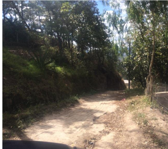
Vista donde se ve el mal estado de la calle.
