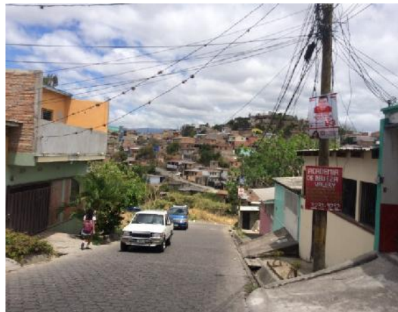
VISTA DEL ESTADO DE LOS ADOQUINES EXISTENTES
