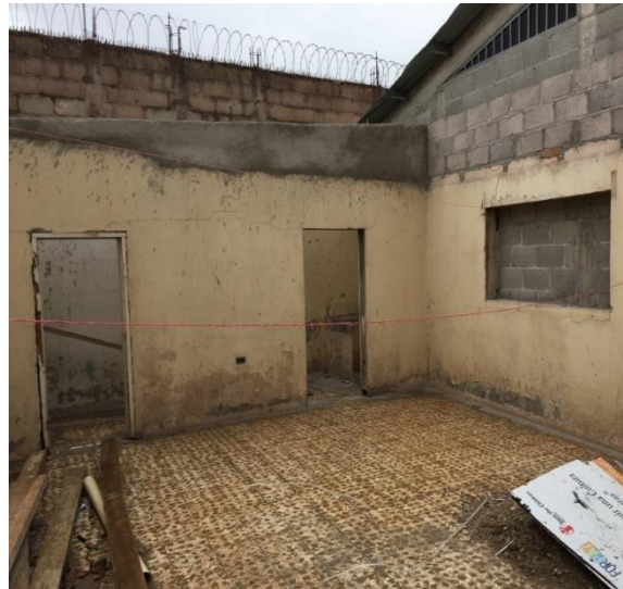
Paredes a demoler en mal estado.
