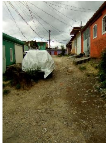
segundo tramo calle de tierra y tubería metálica oxidada
