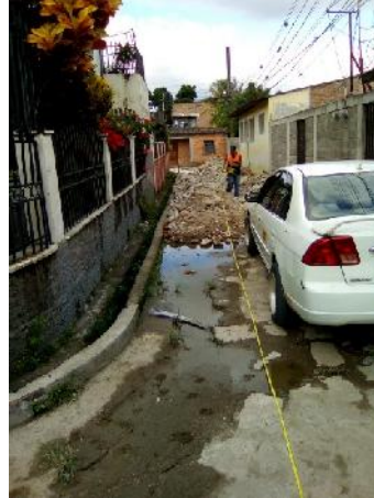
area de empedrado a reparar
