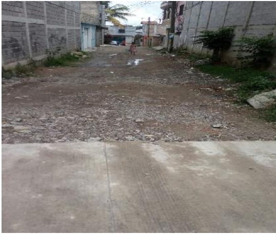
se observa el mal estado de la calle
