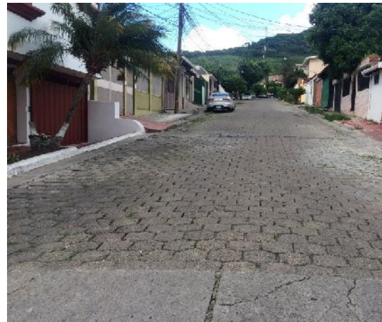
se observa el mal estado del adoquin existente
