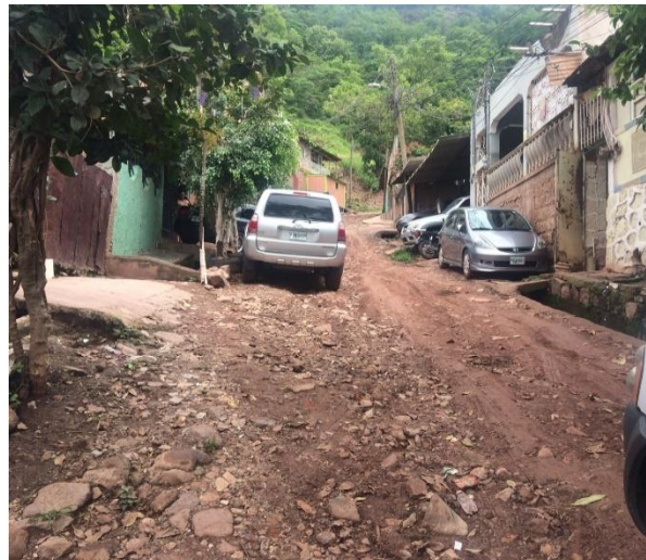
Se observa el mal estado de la calle, la pendiente del terreno natural, cunetas para drenaje y aceras en algunos tramos.
