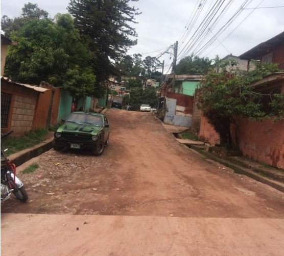
Se observa el estado actual de la calle, el tramo cuenta con cunetas para drenaje en ambos lados de la calle y conecta con la red pavimentada
