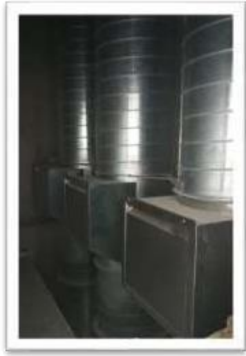
Fig. 1. Ductos de las basuras en el Edificio 1847
