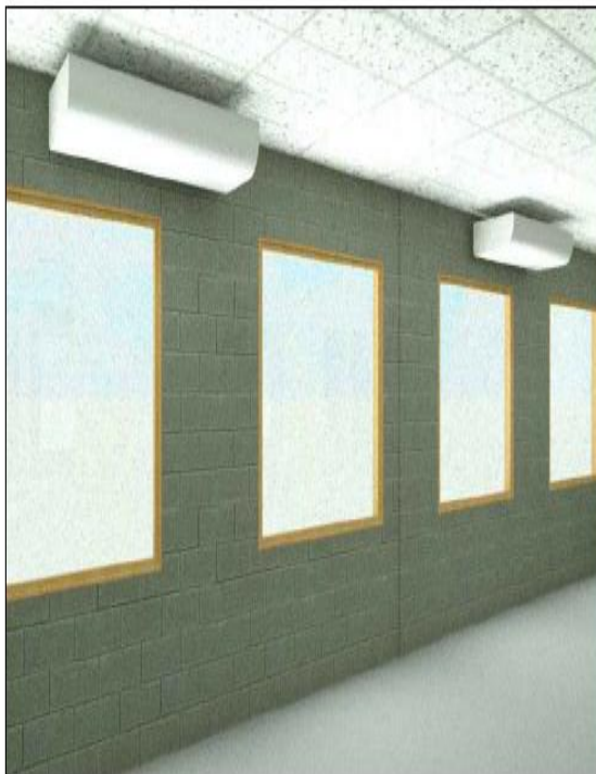
Vista de la Instalación de la Unidad Evaporadora Tipo Piso Techo.
