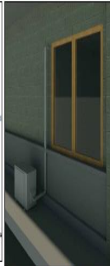
Vista de la Instalación de la Unidad Condensadora Ala Oeste.
