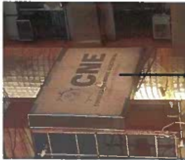
ESTRUCTURA DE METAL EXISTENTE ROTULO OPACO Y DESGASTADO POR AMBOS LADOS DE 5x3 mts CON ILUMINACION INTERNA
